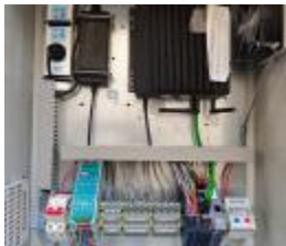
系统一体化采集终端：集成数据采集、存储与传输功能的工业级测试机柜
